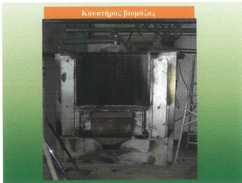
Σχήμα 8. Καυστήρας καύσης πυρηνόξυλου
