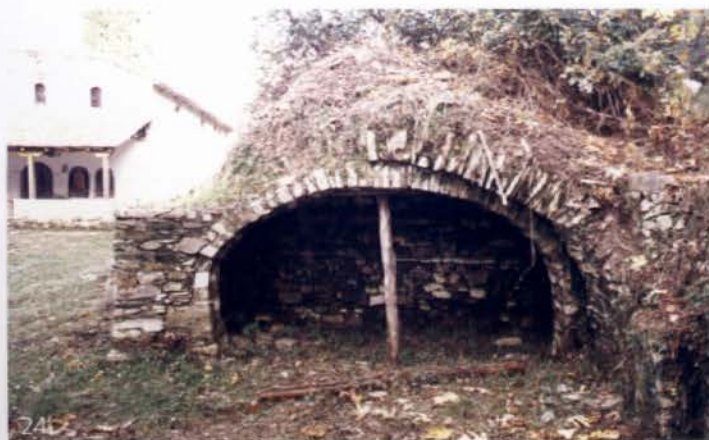
Εικ.24. Ι.Μ. Ταξιαρχών Ζαγοράς. ΝΔ πλευρό. Ερείπια κτισμάτων.
